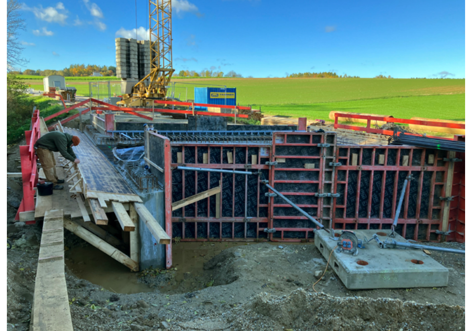
Der Durchlass für den Holzener Bach während der Arbeiten. Foto: Reinhard Huber/Staatliches Bauamt Landshut
